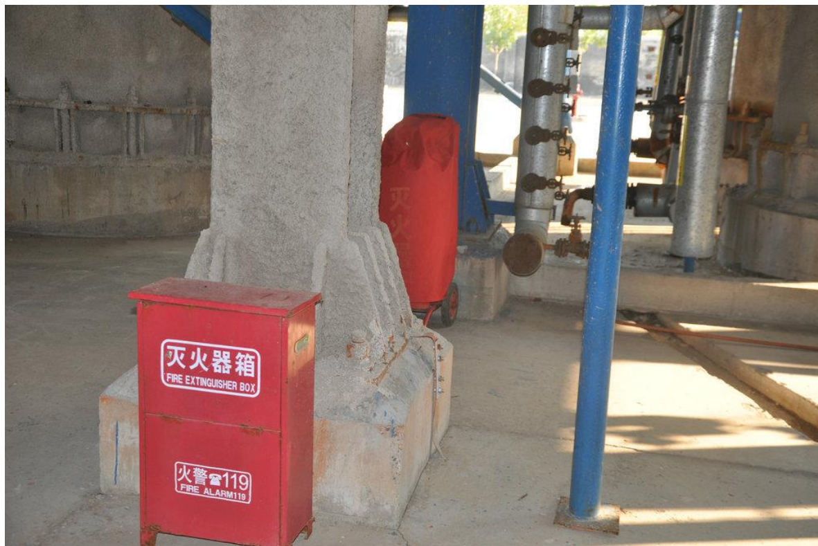
装置区消防器材
