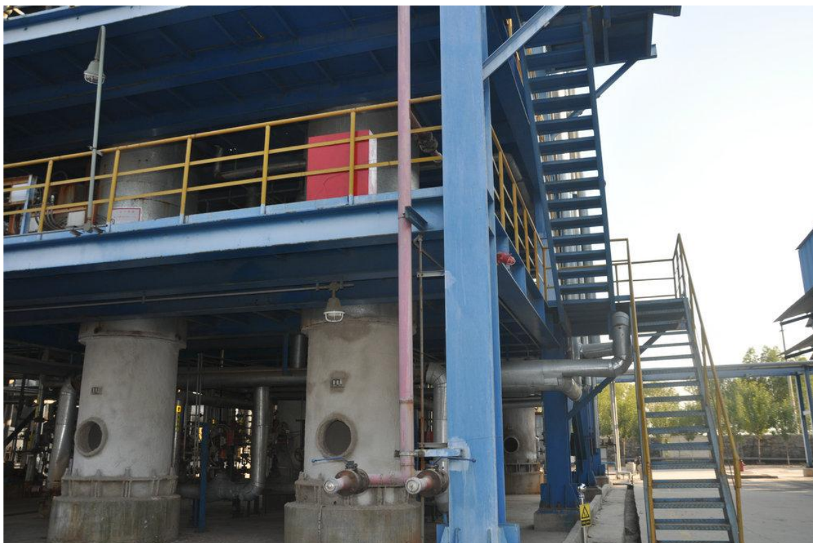
装置区消防设施（消防立管）
